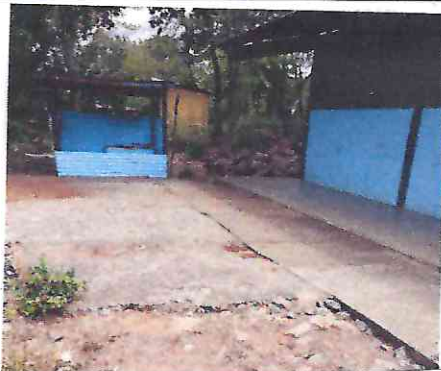
Foto 6: Cocina en mal estado
